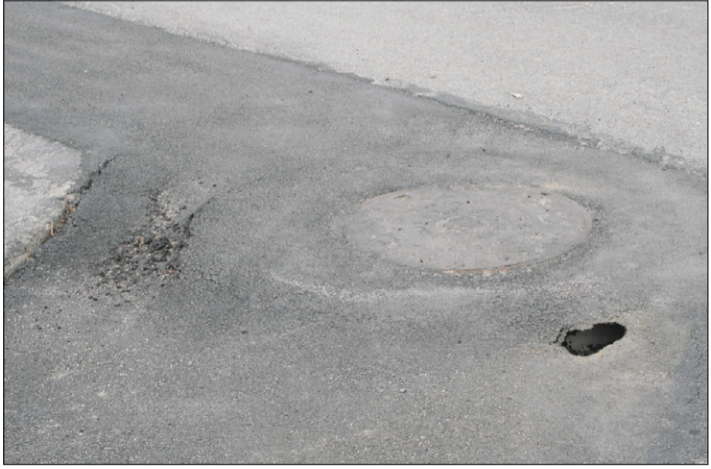
고성군이 지난해 12월 31일 준공한 고성군생활체육관 진입로 보도블럭이 심하게 가라앉은 모습(사진 맨위), 나머지 2장의 사진은 오수관로 공사를 한 뒤 아스콘 작업을 한 것이 제대로 되지 않아 곳곳에 구멍이 뚫리고 가라앉은 모습.
