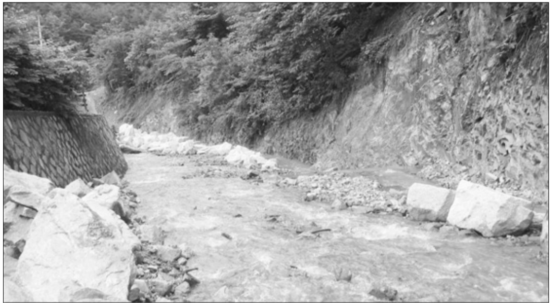
고성군산림조합이 죽왕면 구성리 구둔교 상류 소하천에서 진행 중인 석축공사가 예산낭비라는 지적을 받고 있다. 사진은 지난달 27일 현장 모습. 우측으로 돌산을 깎은 흔적이 보인다.
