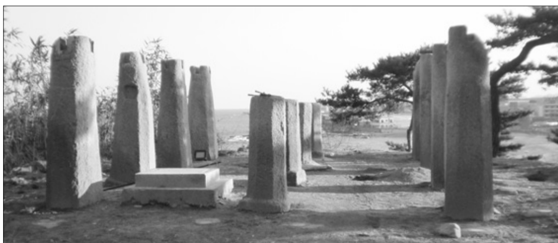
청간정 해체·복원 공사로 인해 모습을 드러낸 12개의 주춧돌들. 이 주춧돌은 1560년 간성군수 최천이 청간정을 중수할 때부터 사용했던 것으로, 청간정의 문화재적 가치를 인정받을 수 있는 귀중한 자료이다.
